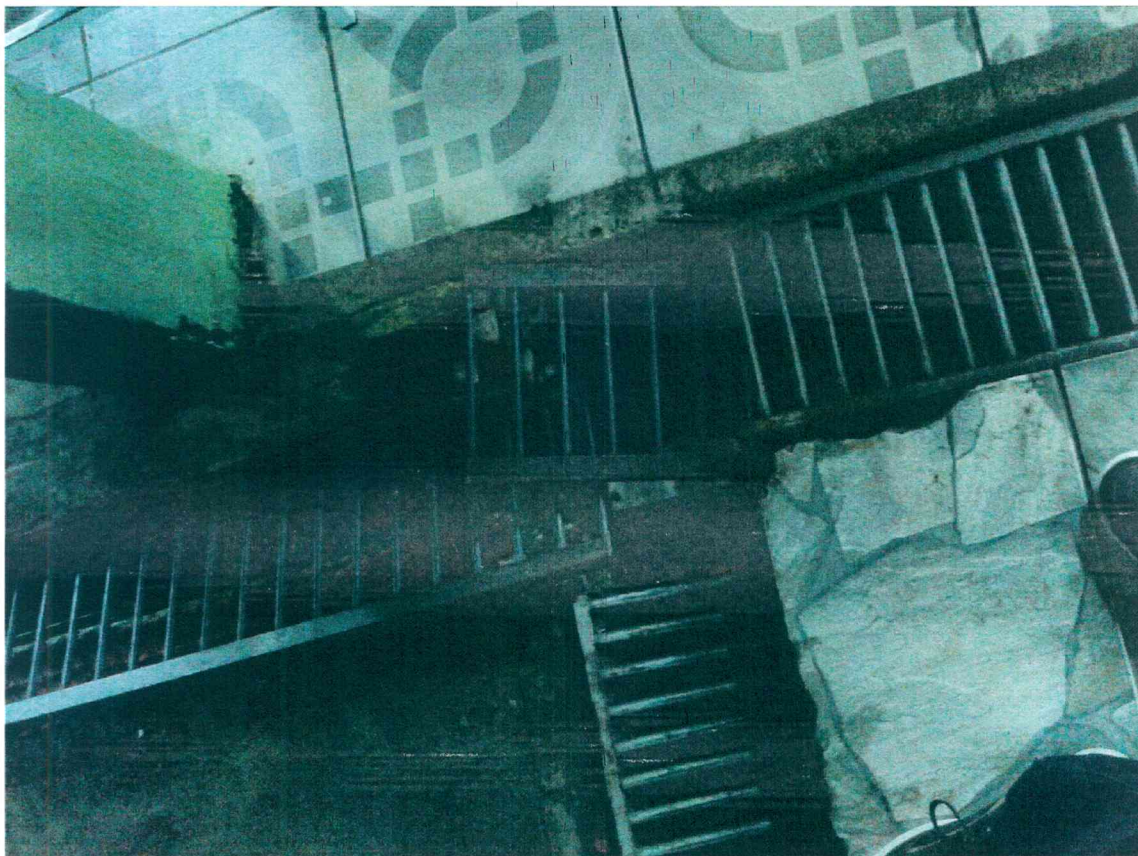
Figura 1 - Tampa metálica da calha de escoamento.
