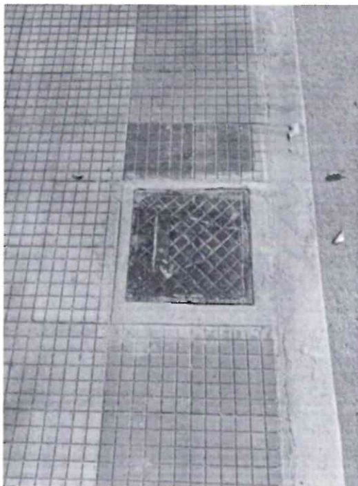
CAIXA DE PASSAGEM
